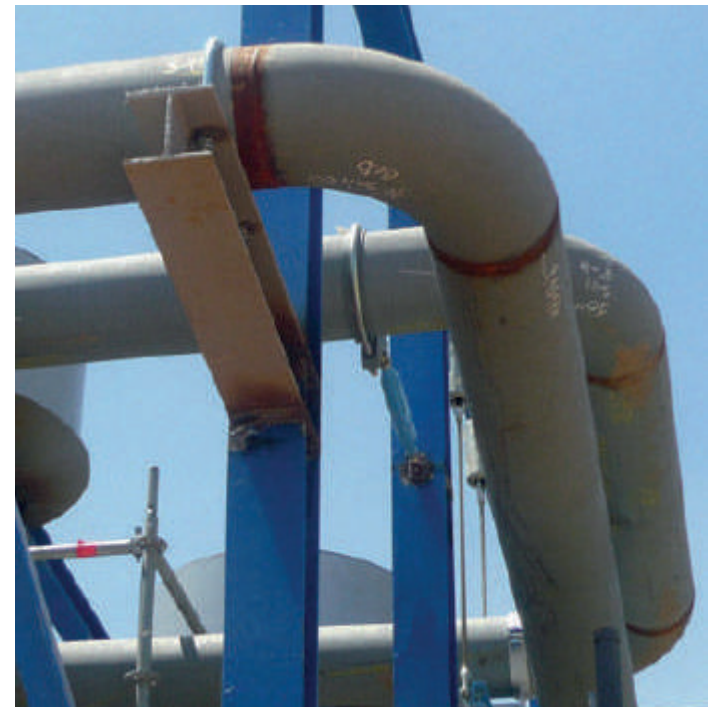
◆ Soportes para tuberías aéreas
