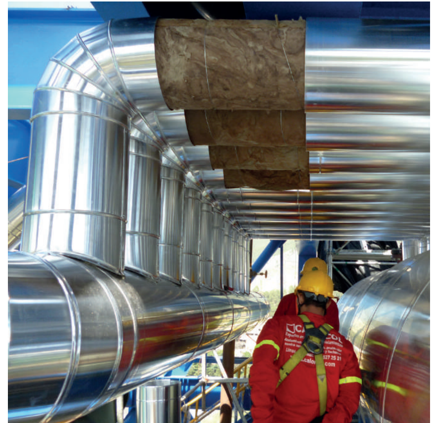
◆ Aislamiento de Tuberías
