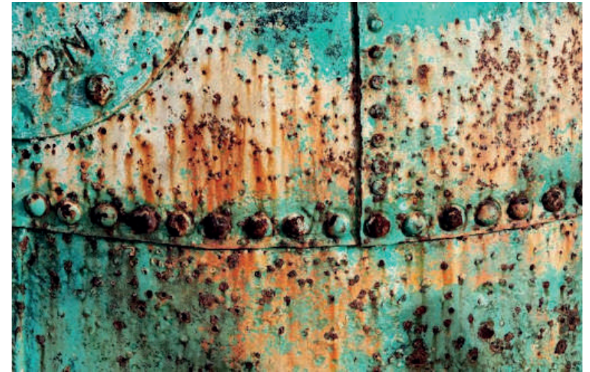
◆ Corrosión en Tuberías
